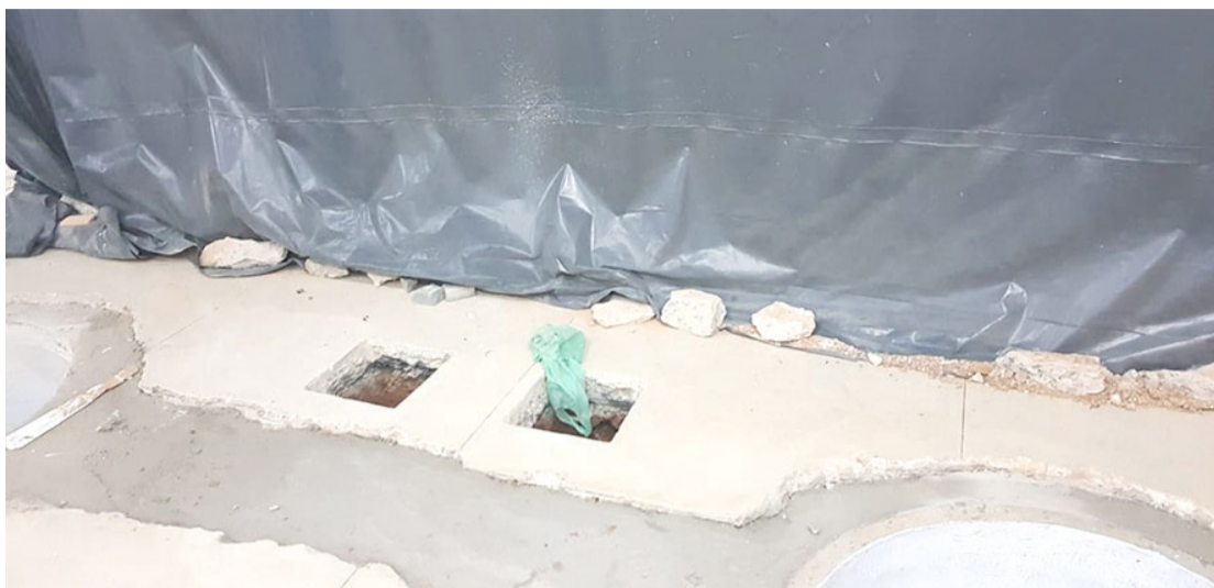
Na vistoria do Conselho de Saúde foi constatada a incapacidade de funcionamento da lavanderia
