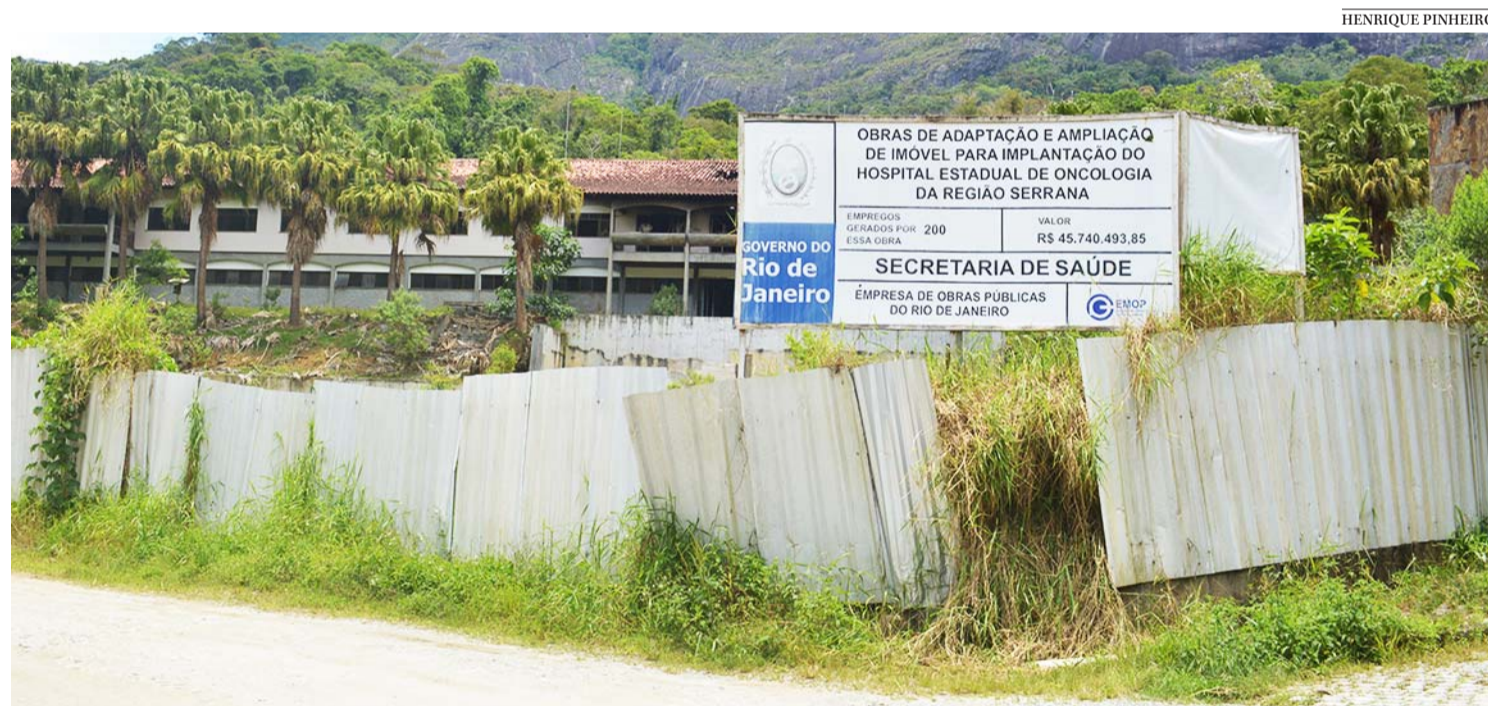
As obras do futuro Hospital do Câncer Francisco Faria estão paralisadas há quase dois anos. Unidade vai funcionar no antigo Cavs, na Ponte da Saudade
